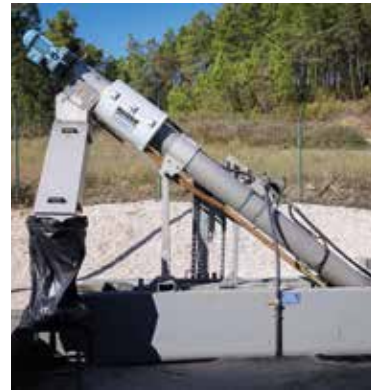
Tamisador da obra de entrada
