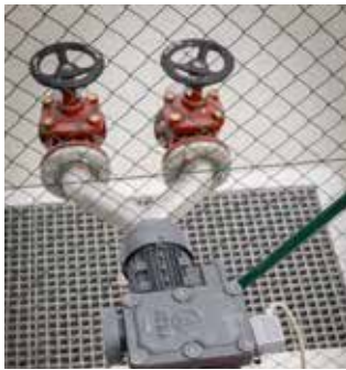
Receção de efluentes por via rodoviária
