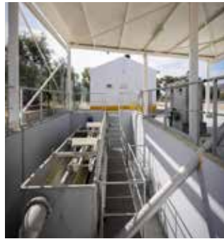
Tratamento preliminar compacto
